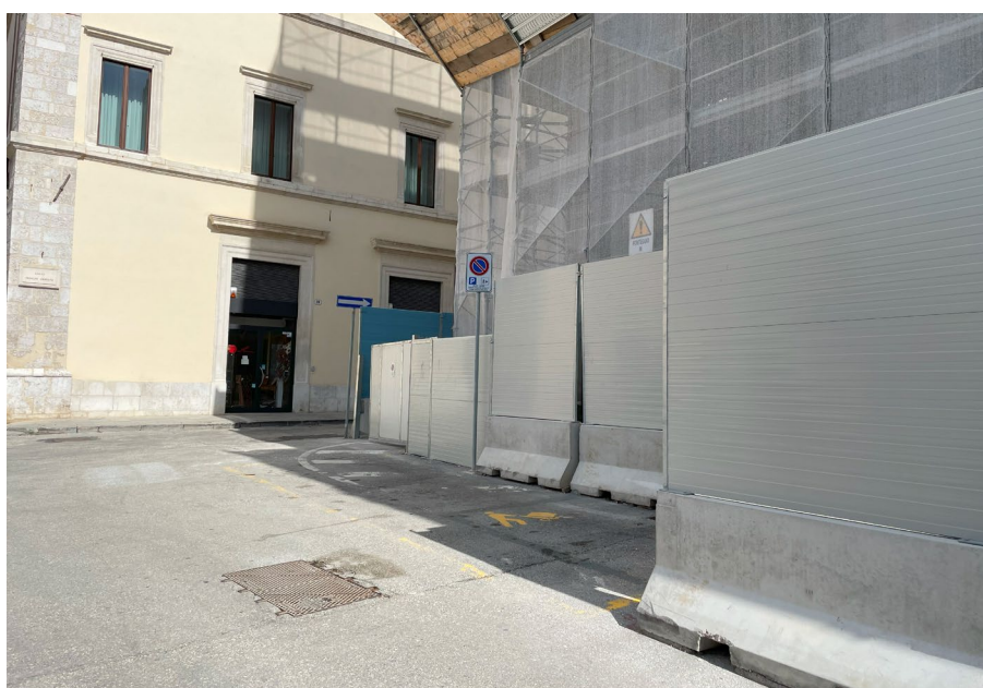
figura 9 - Esempio di stallo merci non utilizzabile causa cantieri edili
