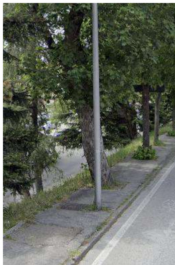
Figura 37-presenza di un palo che ostacola il passaggio lungo Via XX Settembre, in particolare a persone con mobilità ridotta
