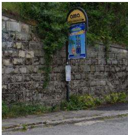
Figura 35 – Fermata in via XX Settembre; risulta inadeguata sia per la poca visibilità e sia per l'inadeguatezza ai fini della sicurezza
